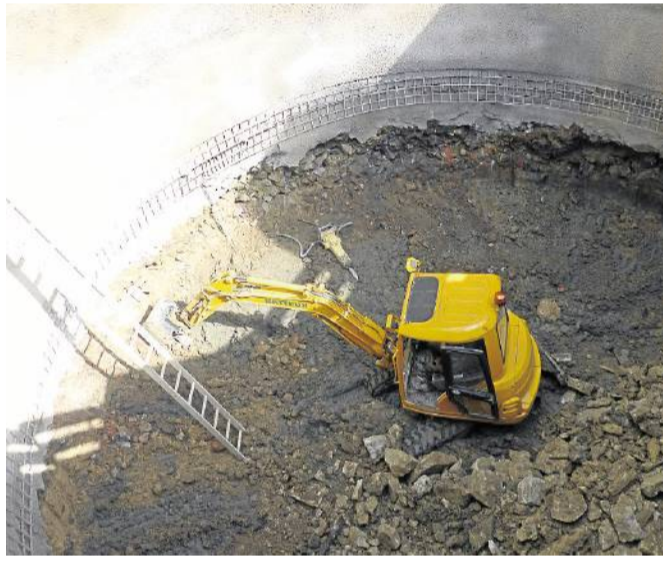
In der Baugrube am Oelckenturm stießen die Bagger bereits auf Reste des verfüllten Stadtgrabens.
