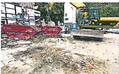
Rund um die Baugrube hat sich stellenweise der Boden unter der Last des Baggers abgesenkt.
