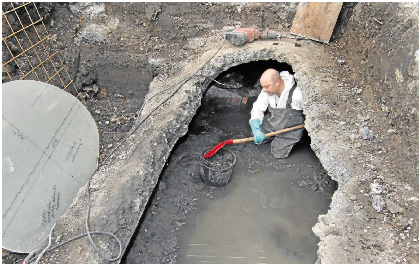
Mitarbeiter einer Kanalsanierungsfirma reinigten einen Abschnitt des Kortelbachs am Ostring im Jahr 2012. Ab 2016 soll parallel zum alten Kanalrohr eine neue Trasse für den saubereren Bach verlegt werden. Jetzt werden die Detailplanungen öffentlich. Foto: Archiv
